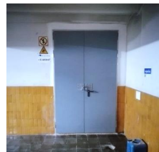
Porta RF doble instal·lada
