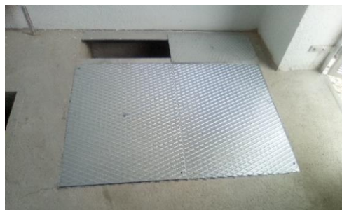
Bancada BT i arquetes al Centre de Transformació
