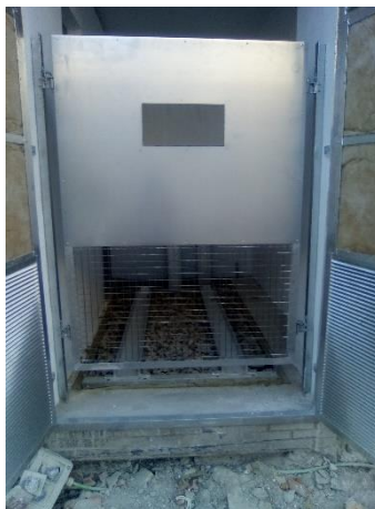
Mampara entre porta i traf
