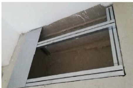
Bancada MT en Centro de Transformación
