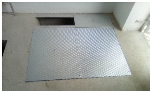
Bancada BT y arquetas en Centro de Transformación
