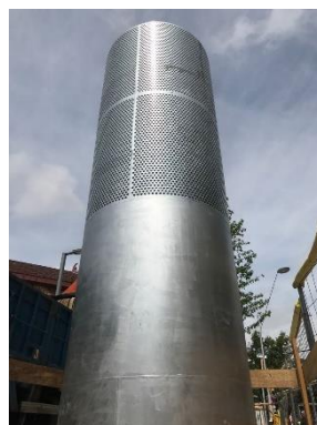
Torre ventilación grandes dimensiones, instalada (Mercat Sant Antoni, Barcelona)
