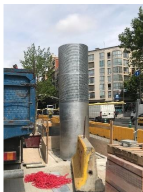
Torre ventilación grandes dimensiones, en obra (Mercat Sant Antoni, Barcelona)
