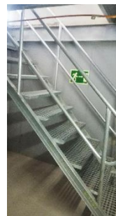
Escalera de barco con peldaños de tramex
