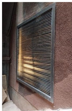
Reja de ventilación
