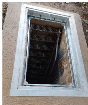
Cadre de siphon étanche
