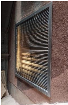
Grille de ventilation
