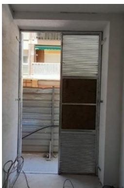
Porte CT intérieure
