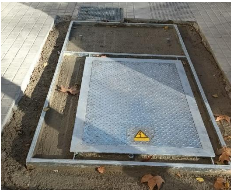
Trapa in calcestruzzo misto
