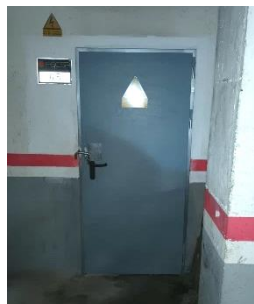
Singolo gate RF installato
