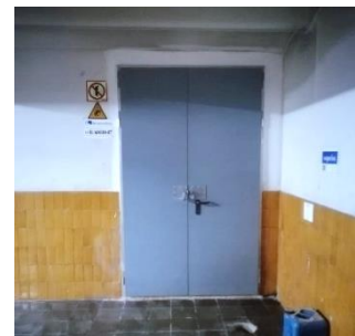
Doppio gate RF installato
