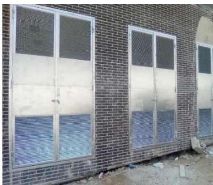
Portas de ventilação superiores e inferiores, com ângulo invertido
