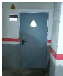
Portão RF único instalado
