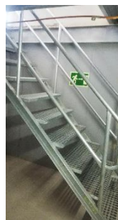
Escada para barco com degraus tramex
